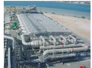
MSF 型海水淡水化プラント (UAE)
